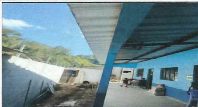
Foto 1: MÓDULO 2 LOSA DE PISO POR QUE EL ÁREA SE ENLODA MUCHO
