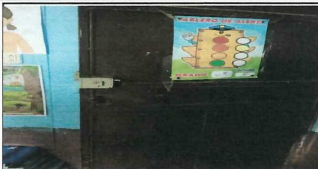
Foto 2: MÓDULO 4 AULA 2 CAMBIO DE PUERTA YA QUE TIENE UN ORIFICIO A UN COSTADO DE LA CHAPA
